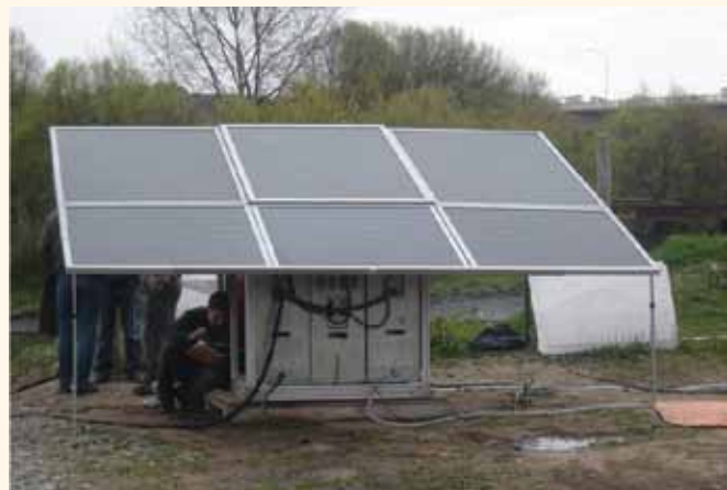
Este sistema portátil de purificação de água é utilizado pelo Exército Chileno para coletar energia eólica e solar.
