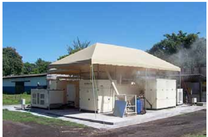
Gaseificador de biomassa em El Salvador.
